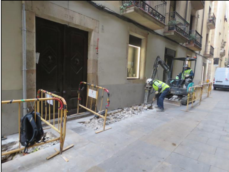
Tram 3 de la Rasa 1 afectació del paviment i planxé
